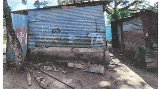
Foto 2: Derivado del deterioro de la lamina se necesita cambiar por lamina troquelada
