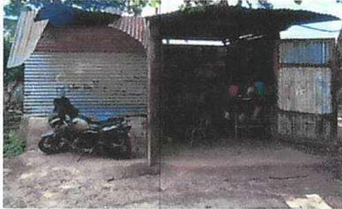
Foto 1: Debido al deterioro del taller de mecanicos se necesita sustituir la madera por estructura de metal
